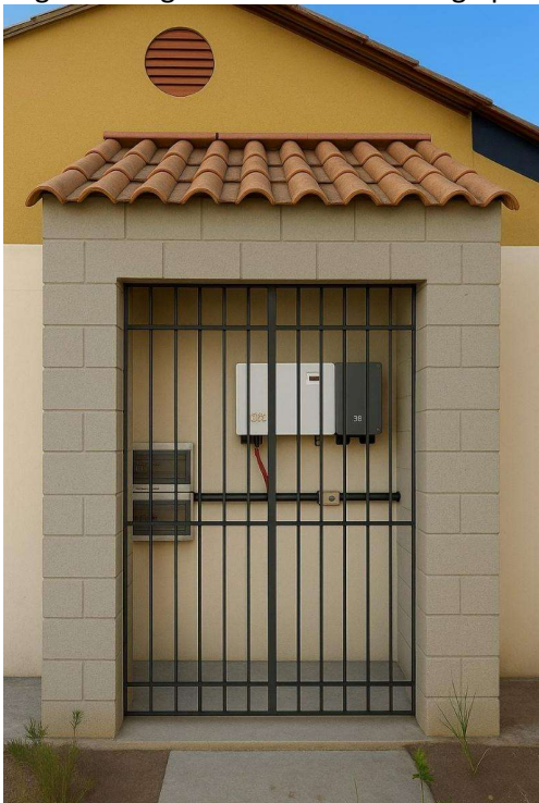
PADRÃO DE ENTRADA – ADEQUAÇÃO À NOVA DEMANDA DO SISTEMA FOTOVOLTAICO
